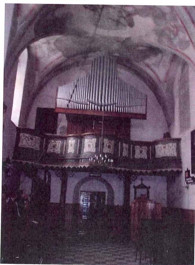
fot. nr 6 WNĘTRZE KOŚCIOŁA Z WIDOCZNYMI WYKWITAMI NA SKLEPIENIACH
